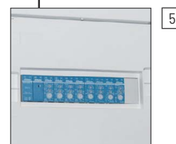
SUB-DISTRIBUIDOR PLANTA BAJA
